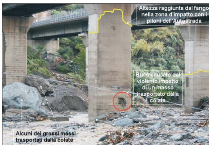
Figura 9 – Esempio degli enormi massi di rocce inglobati e trasportati dalla colata fangosa detritica depositi sotto ai piloni dell'autostrada Messina Catania. Foto Zancle.it.
