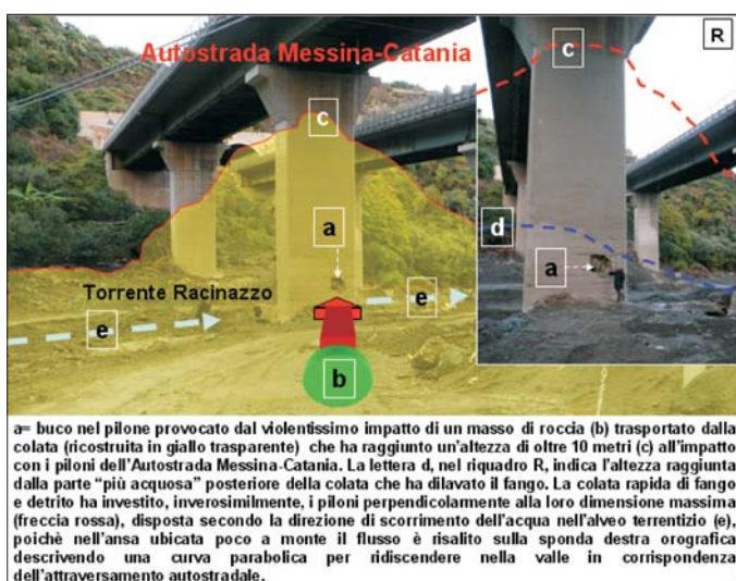
a= buco nel pilone provocato dal violentissimo impatto di un masso di roccia (b) trasportato dalla colata (ricostruita in giallo trasparente) che ha raggiunto un'altezza di oltre 10 metri (c) all'impatto con i piloni dell'Autostrada Messina-Catania. La lettera d, nel riquadro R, indica l'altezza raggiunta dalla parte "più acquosa" posteriore della colata che ha dilavato il fango. La colata rapida di fango e detrito ha investito, inverosimilmente, i piloni perpendicolarmente alla loro dimensione massima (freccia rossa), disposta secondo la direzione di scorrimento dell'acqua nell'alveo torrentizio (e), poiché nell'ansa ubicata poco a monte il flusso è risalito sulla sponda destra orografica descrivendo una curva parabolica per ridiscendere nella valle in corrispondenza dell'attraversamento autostradale.
