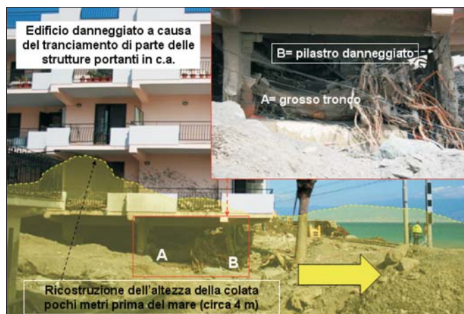
Figura 14 – Ricostruzione dell'altezza e della potenza della colata a poche decine di metri dalla spiaggia. Sono evidenti i danni arrecati dai grossi massi inglobati nella colata alle strutture portanti in c.a. dell'edificio multipiano. Foto Zancle.it.
