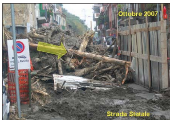
Figura 24 – Colata di fango innescatasi ed evoluta invadendo la strada statale, nell'ottobre 2007, lungo il breve ma ripido versante incombente su Scaletta Zanclea Marina tra il Torrente Racinazzo e il Torrente Divieto. Il flusso ha inglobato molti alberi d'alto fusto. Foto Zancle.it.
