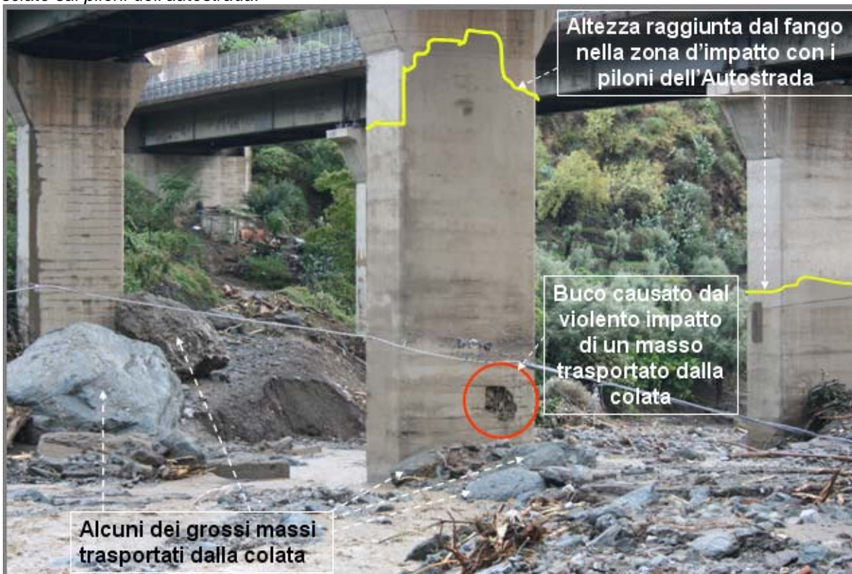
Figura 9: Esempio degli enormi massi di rocce inglobati e trasportati dalla colata fangosa detritica depositi sotto ai piloni dell'autostrada Messina Catania. Foto Zancle.it
