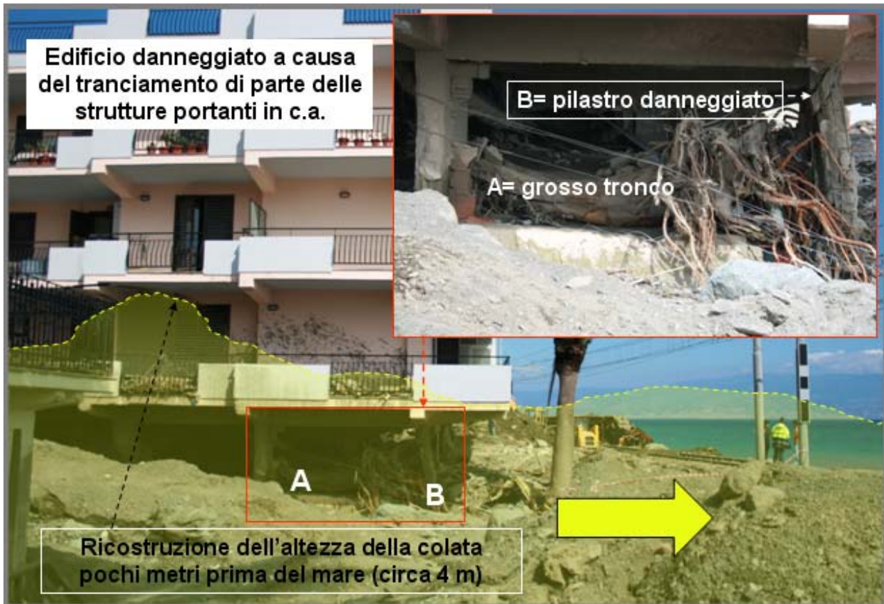
Figura 14: Ricostruzione dell'altezza e della potenza della colata a poche decine di metri dalla spiaggia. Sono evidenti i danni arrecati dai grossi massi inglobati nella colata alle strutture portanti in c.a. dell'edificio multipiano. Foto Zancle.it.
